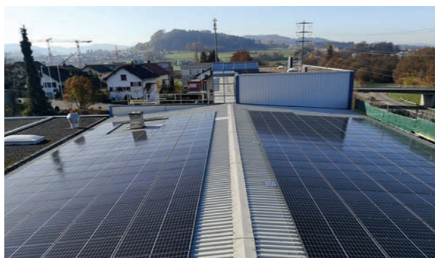
Photovoltaikanlage auf dem Dach an der Mattenrainstrasse 9.
